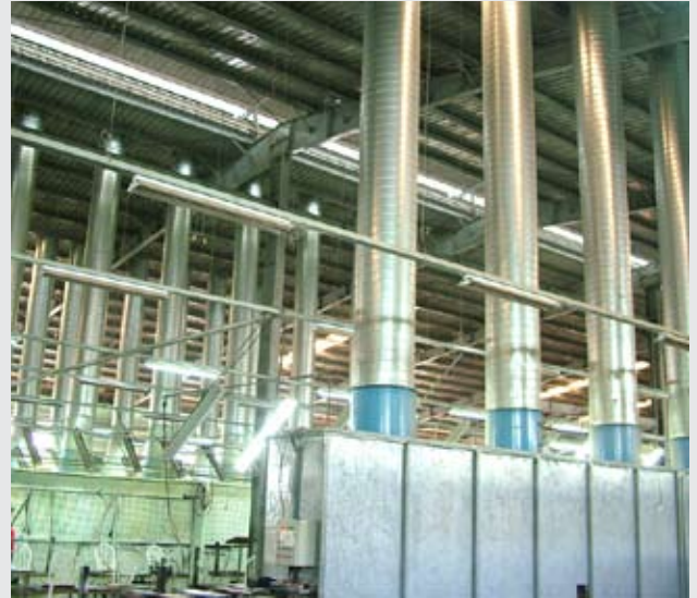
Hệ thống xử lý bụi tại nhà máy của TTF
